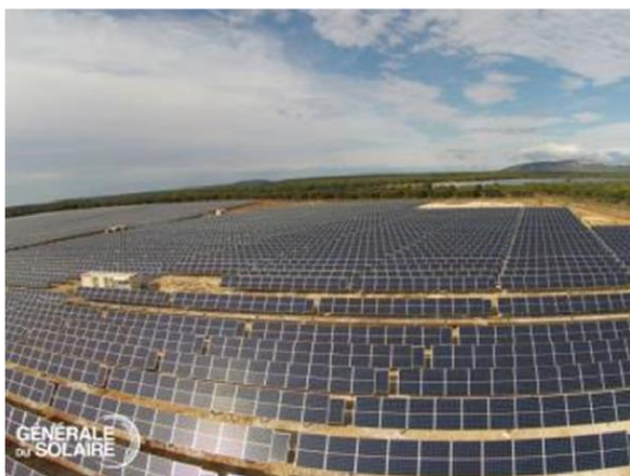
Centrale de Belvezet, Gard
